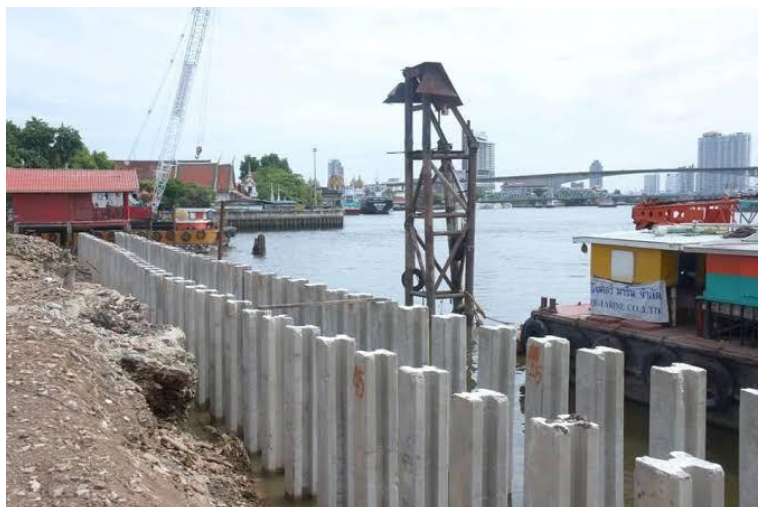
รูปแสดงการก่อสร้างกำแพงแบบตอกเข็มเสียบแผ่นกันดิน
