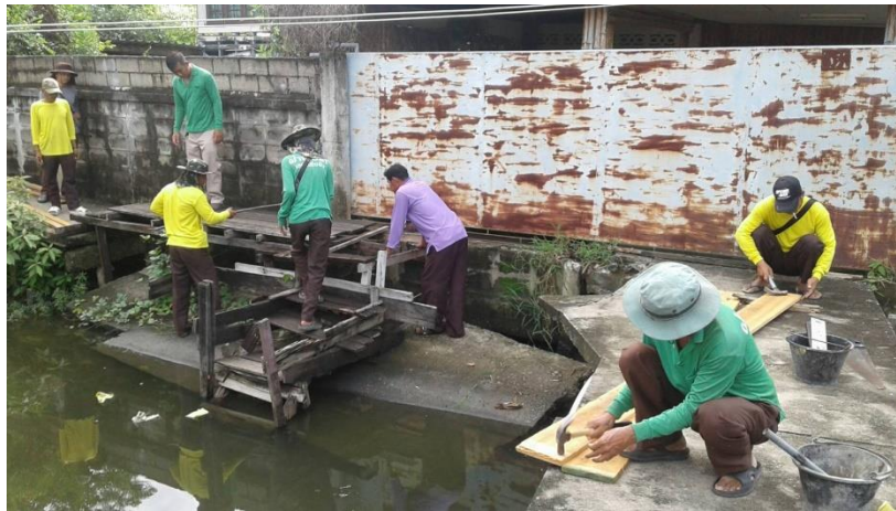
ภาพที่ ๓ สภาพสะพานทางเดิน ค.ส.ล.ทรุด ในพื้นที่กรุงเทพมหานคร
