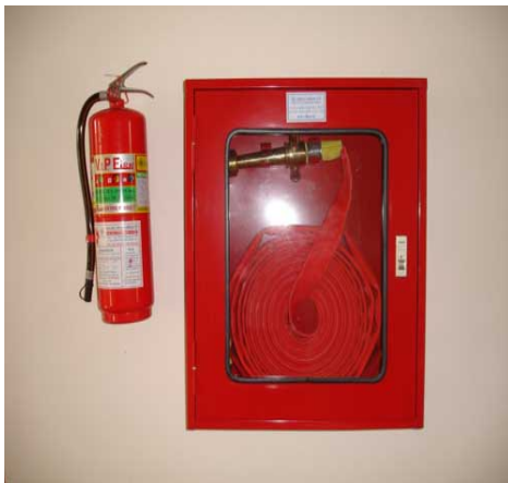
ตู้อุปกรณ์ดับเพลิงในอาคาร
